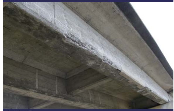
高架橋の劣化
