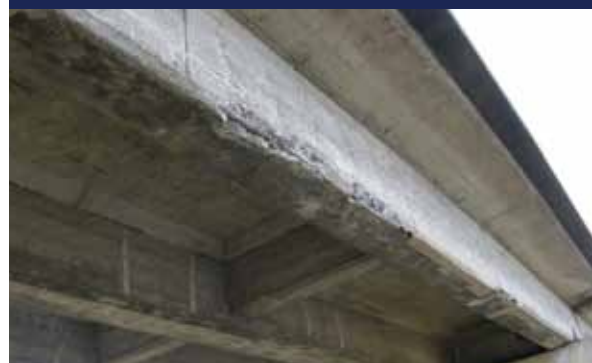
高架橋の劣化
